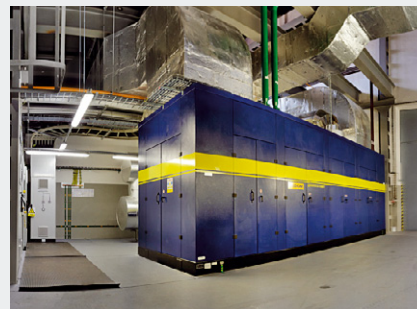
Kogenerační jednotka Prostějov (ČEZ Energo)
